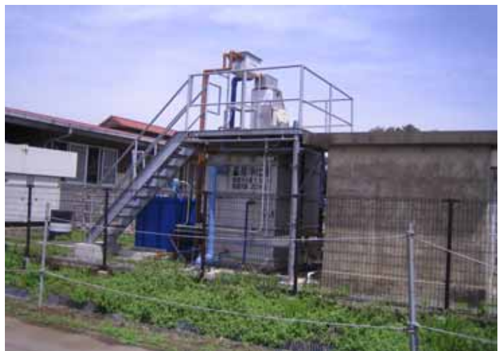
整備された畜産污水处理施設
