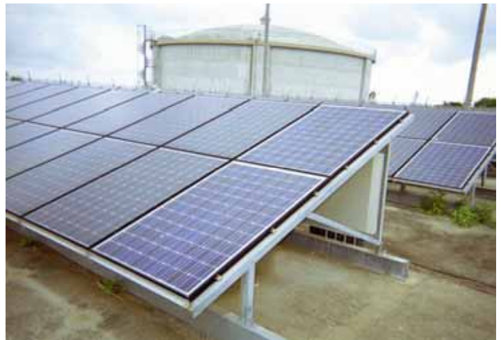
設置された太陽光発電パネル
