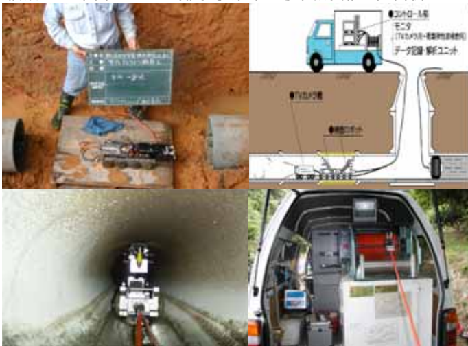
テレビカメラによるパイプラインの機能診断
