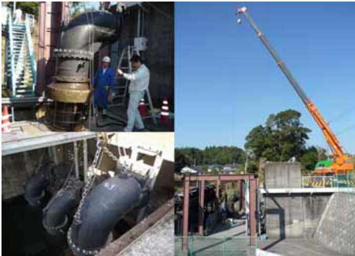
大口径水中ポンプの機能診断
